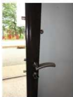
porte métallique blindée isolée
